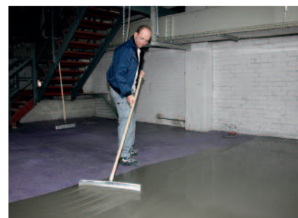
Mit PCI Periplan® Multi läßt sich ein schnell belastbarer Bodenausgleich einfach herstellen
