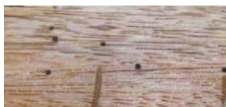
„Pinholes“ bei überseeischen Harthölzern
