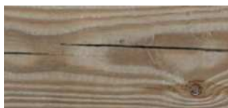
Spannungsrisse durch die Holz-trocknung
