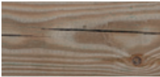
Spannungsrisse durch die Holz-trocknung
