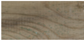
Raue Stellen auf der Holzoberfläche
