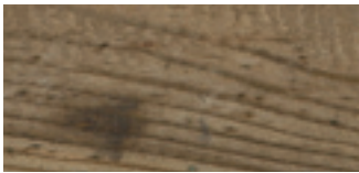
Stockflecken und leichter Schimmelbefall
