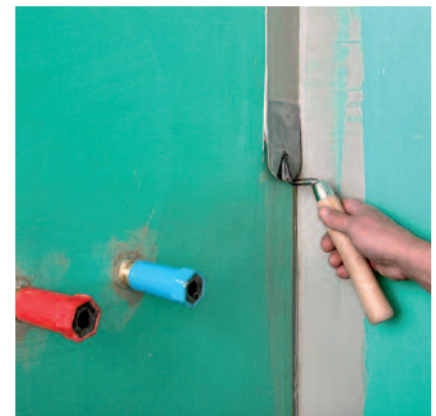
2a. Vor dem Ausführen der Wand-Bodenanschlüsse ausreichend viel Abdichtungsmaterial PCI Lastogum auftragen.
