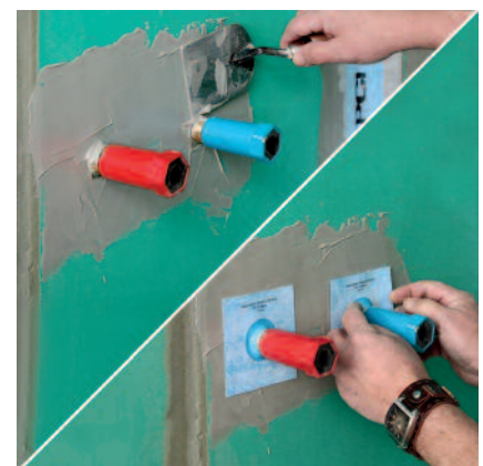
2c. Zum Abdichten der Wasserleitungen wird zunächst ausreichend viel Abdichtungsmaterial PCI Lastogum vorgelegt.
